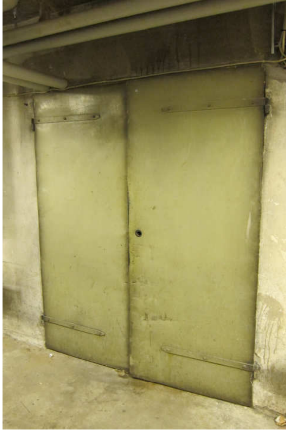
Alkuperäiset palo-ovet ja niiden karmit sisältävät asbestia.
