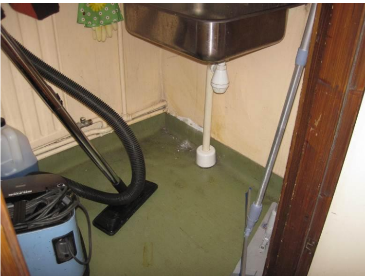
Kuva 13. Rakennuksen 2. kerroksessa siivousvälinevaraston seinärakenteen alaosassa oli havaittavissa kosteusvauriojälkiä. Pintakosteusmittausten perusteella kosteusvauriokohdassa ei ollut havaittavissa poikkeavaa kosteutta.
