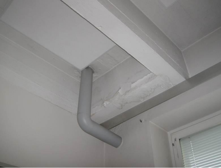
Kuva 8. Tilassa 406 (ryhmätyöhuone 10) katon sadevesisyöksytorven liittymät ovat aiemmin vuotaneet. Pintakosteusmittausten perusteella kosteusvauriokohdissa ei ollut havaittavissa poikkeavaa kosteutta.
