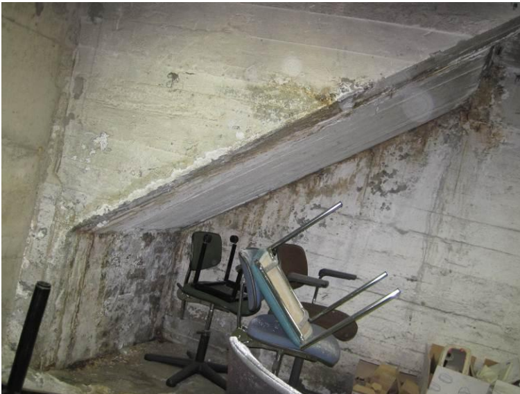
Kuva 18. Varastotilassa 007 olevan portaikon betonirakenteiden pinnoilla on havaittavissa kosteusvauriojälkiä ja poikkeavaa kosteutta pintakosteudenilmaisimella.
