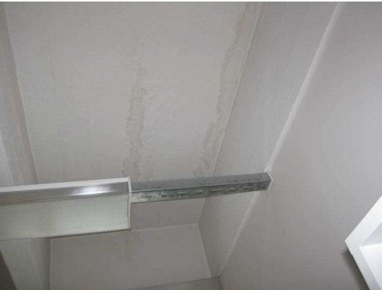
Kuvat 9 - 10. Rakennuksen 4. kerroksen reuna-alueilla yläpohjarakenteessa on havaittavissa pienimuotoisia kosteusvauriojälkiä. Vauriojäljet sijoittuvat pääasiassa rakenteessa olevien halkeamien ja muiden epätiivelyskohtien alueille. Pintakosteusmittausten perusteella kosteusvauriokohdissa ei ollut havaittavissa poikkeavaa kosteutta.
