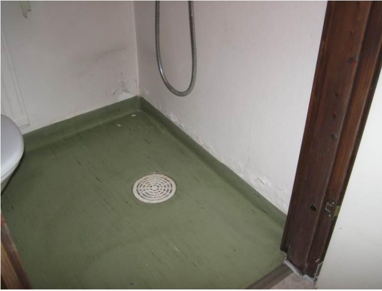
Kuva 11. Rakennuksen 2. ja 4. kerroksissa olevien wc-tilojen seinärakenteiden alaosissa on havaittavissa kosteusvauriojälkiä tiloissa olevien suihkujen kohdilla. Pintakosteusmittausten perusteella kosteusvauriokohdissa ei ollut havaittavissa poikkeavaa kosteutta.
