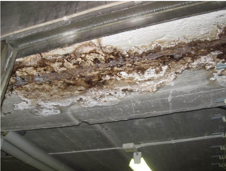
Kuva 21. Varastotilan 007 ja lämmönjakohuoneen välisen oviaukon kohdalla on havaittavissa kosteusvauriojälkiä ja poikkeavaa kosteutta pintakosteudenilmaisimella. Oviaukko sijaitsee rakennuksen ulkopuolella olevan pihakannen ja ulkoseinärakenteen liitoskohdassa.
