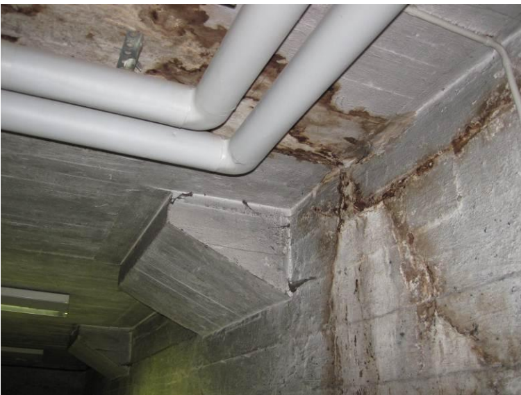
Kuva 19. Varastotilassa 007 pihakannen ja maanpainesseinän liittymässä on havaittavissa kosteusvauriojälkiä ja poikkeavaa kosteutta pintakosteudenilmaisimella.
