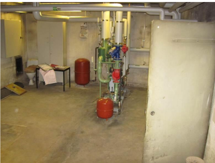
Kuva 22. Yleiskuva lämmönjakohuoneesta. Lämmönjakohuoneen sisäilmassa on havaittavissa voimakasta viemärin hajua.
