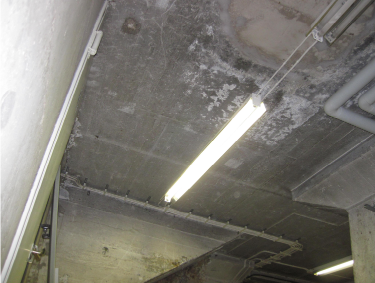
Kuva 20. Kosteusvauriojälkiä on paikoin havaittavissa varastotilassa 007 pihakannen alapinnalla.
